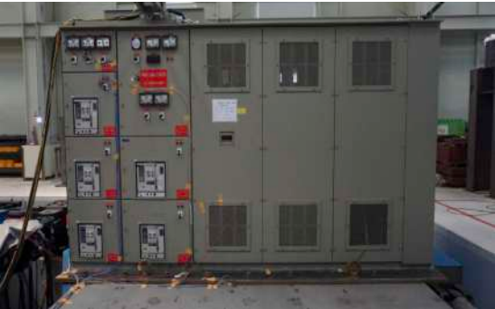
APARELLAJE LV (BAJA TENSIÓN)
